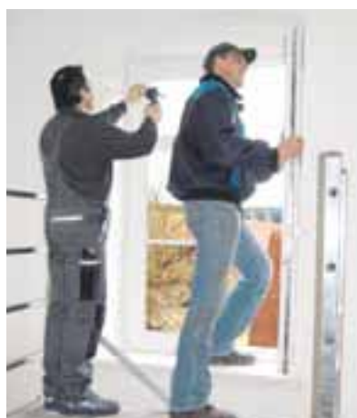
Hier bauen Erich Wiblishauser (links) und Matthias Eberle, stellvertretend für alle Helfer, eines der dreißig neuen Isolierfenster ein. Foto: Karl Kleiber
